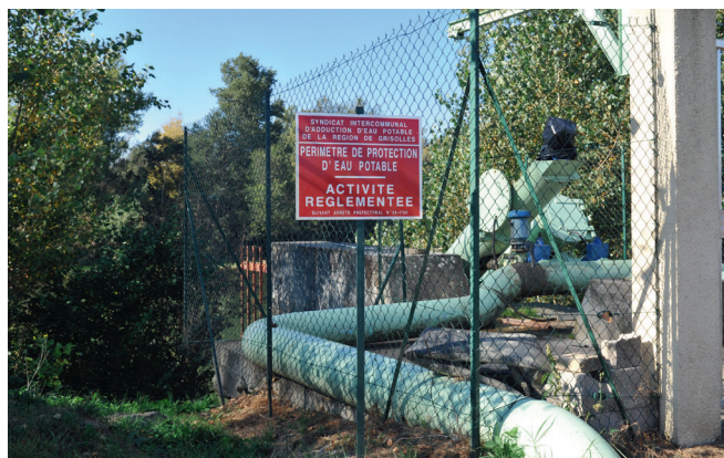
^ Station de pompage d'eau potable dans la Garonne sur la commune de Grisolles en Tarn-et-Garonne
